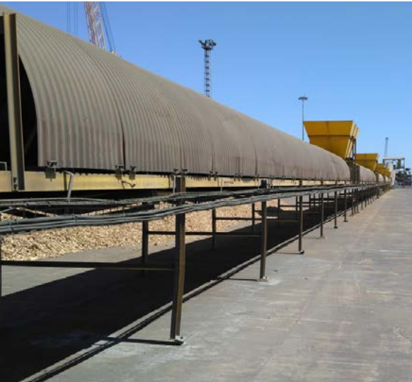
Ejemplo de instalaciones permanente de otro puerto similar, con Tolvas próximas a las zonas de las bodegas de los barcos y cintas transportadoras fijas.
