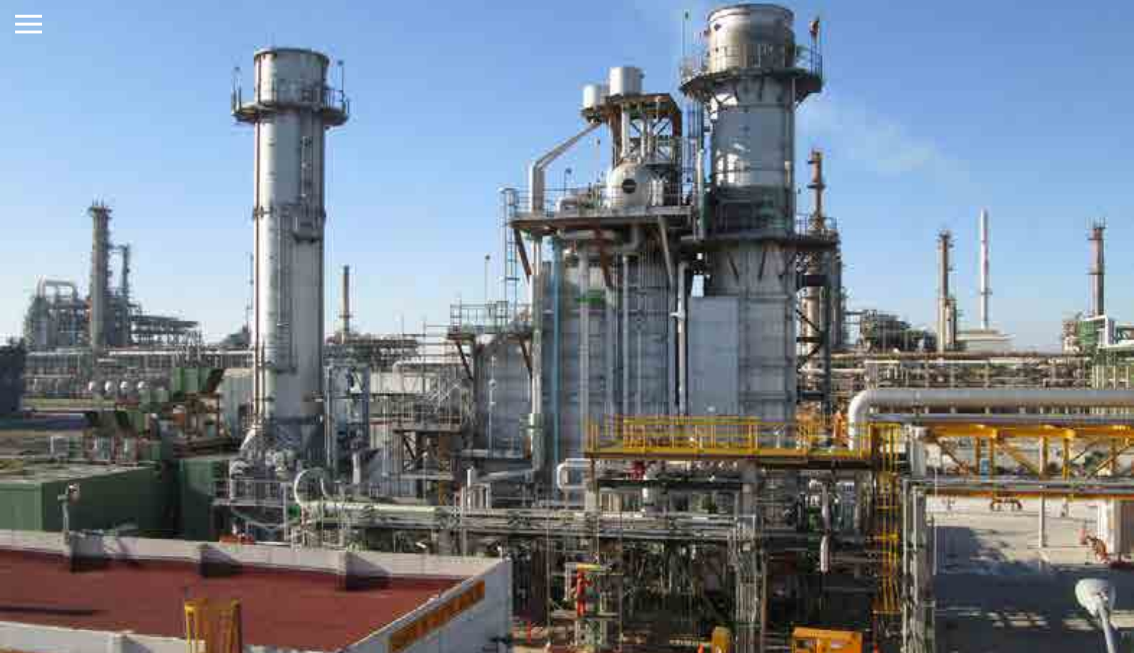
^ Planta de cogeneración. Refinería Francisco I Madero. Madero. México. Cogeneration plant. Francisco I Madero refinery. Madero. Mexico.
