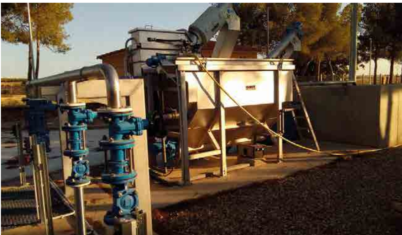
^ EDAR de Tiriez. España. Tiriez WWTP. Spain.
