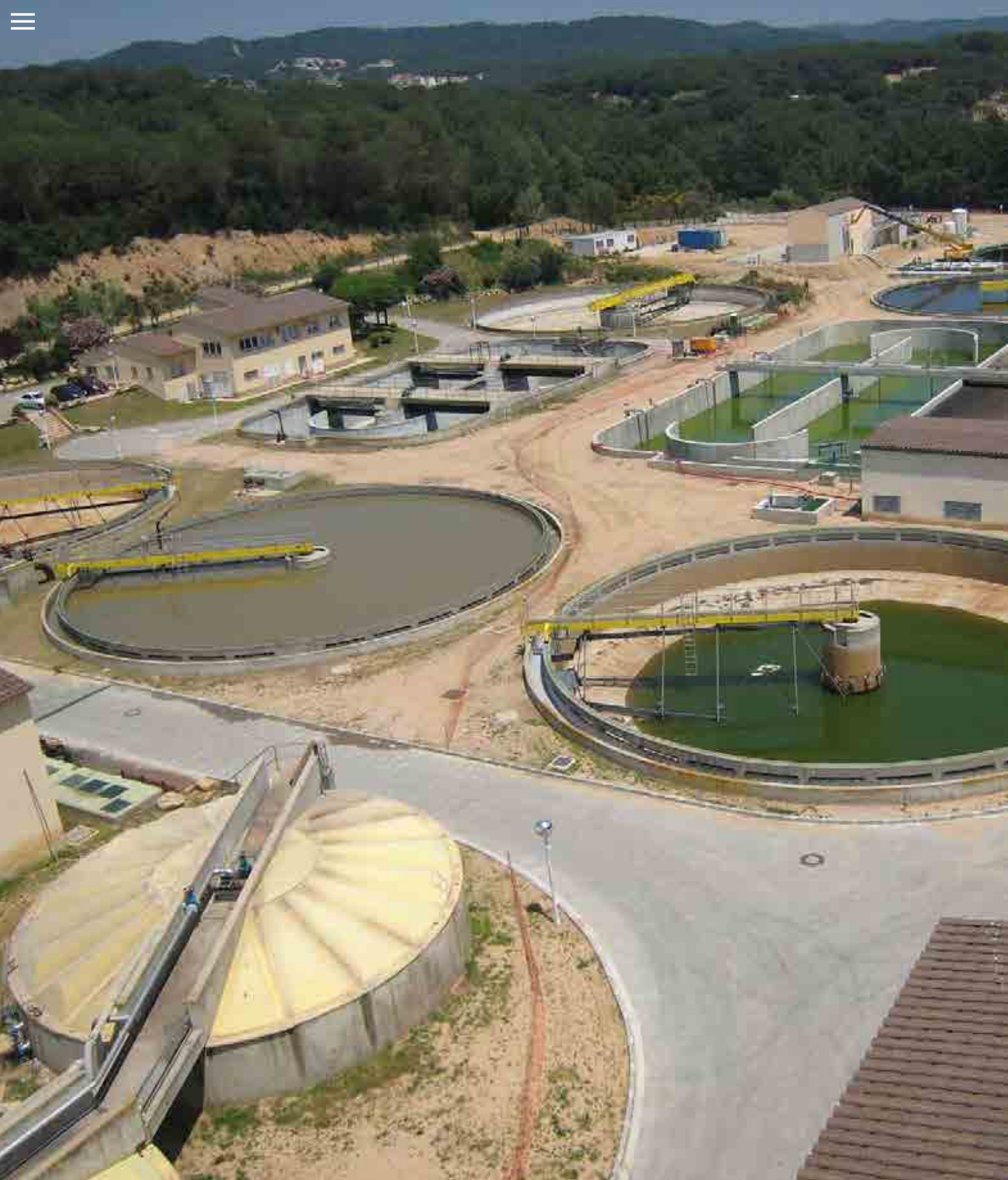
^ EDAR de Lloret de Mar. Ampliación. España. Lloret de Mar WWTP. Expansion. Spain.
