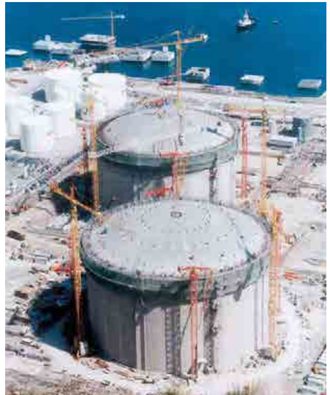
^ Planta regasificadora de gas natural licuado. Puerto de Bilbao (Zierbena). España. Liquefied natural gas regasification plant. Port of Bilbao (Zierbena). Spain.
