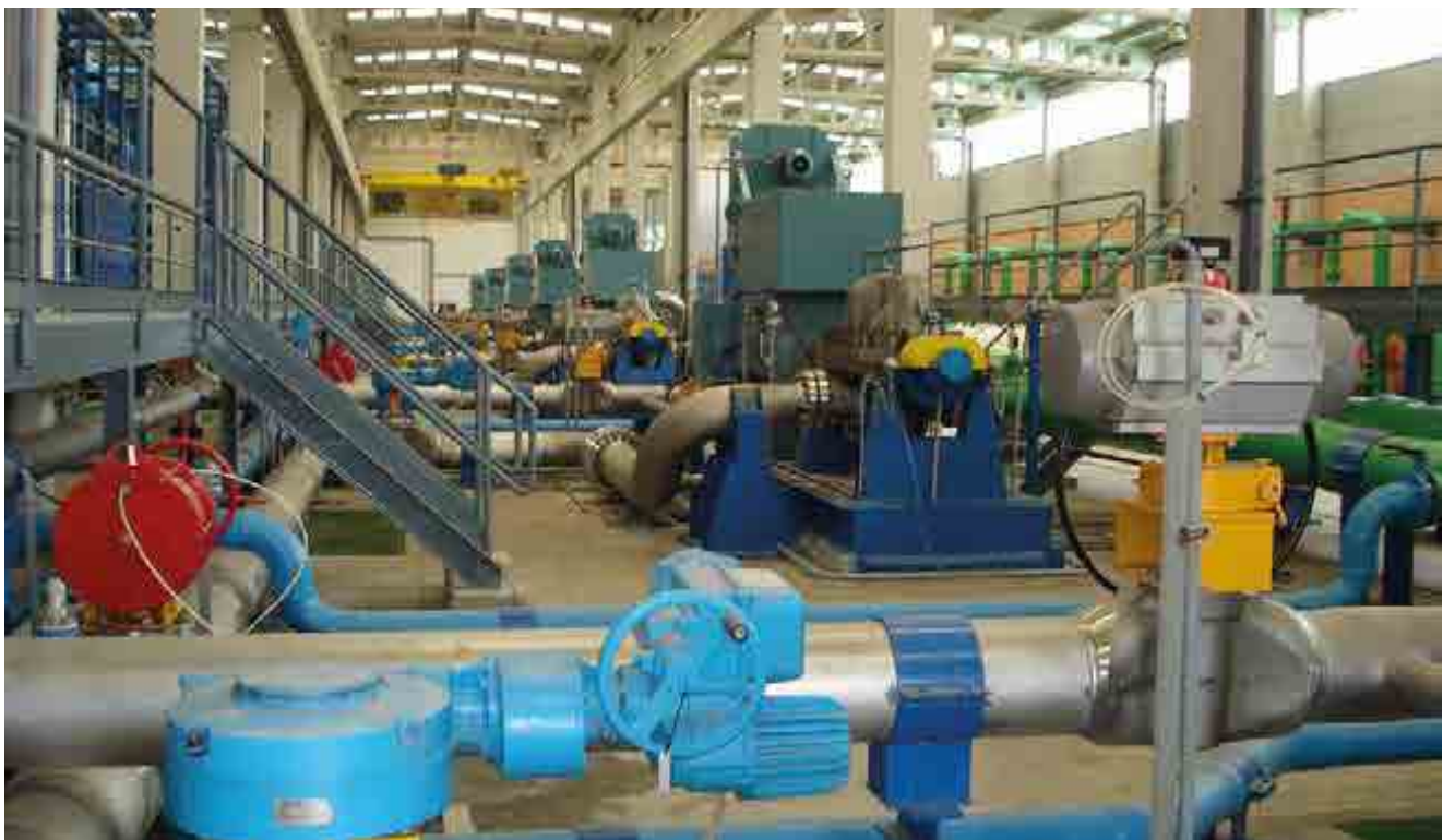
^ IDAM de Carboneras. Sala de proceso. España. Carboneras SWDP. Process room. Spain.
