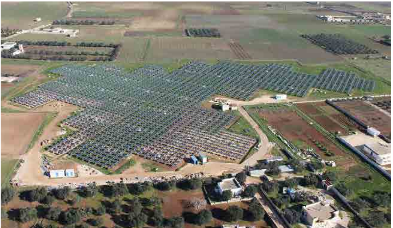
^ Parque solar fotovoltaico. Plugia. Italia. Solar photovoltaic plant. Plugia. Italy.
