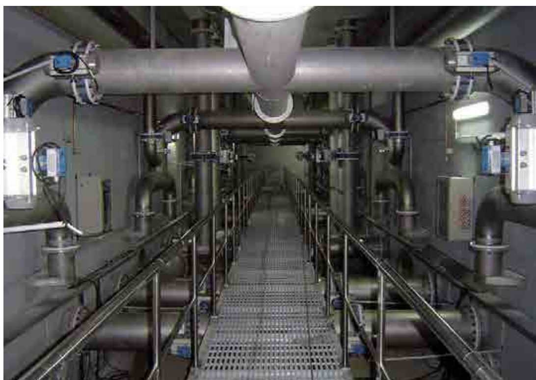
^ EDAR de Benalmádena. España. Benalmádena WWTP. Spain.
